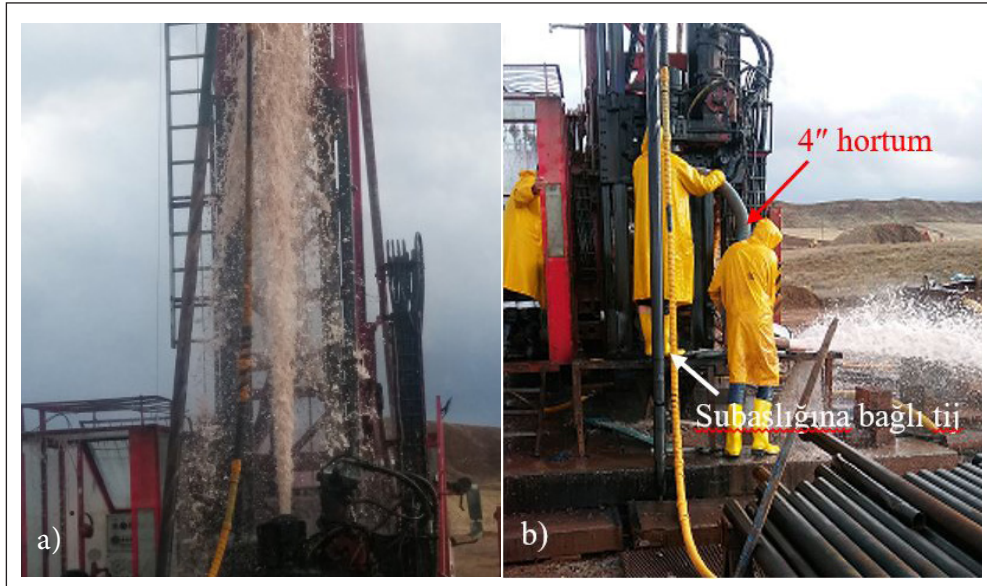
Şekil 3- a) Manevra başlığının sökülmesi sonucu formasyon akışkanı püskürmesi, b) Su başlığını bağlamadan önce akışkanın akış yönünün plastik hortumla yönlendirilmesi.
