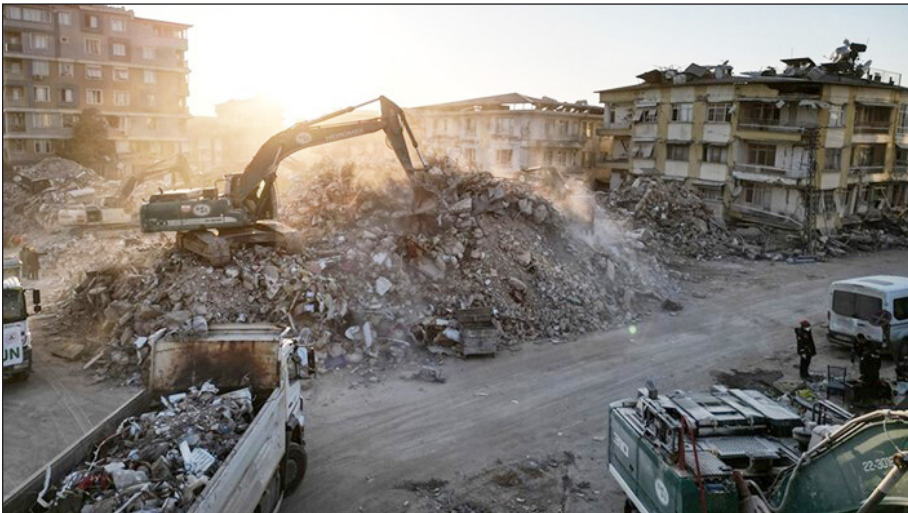
Şekil 2 - İnşaat ve yıkıntı atığı örneği (Anadolu Ajansı, 22 Şubat 2023).
